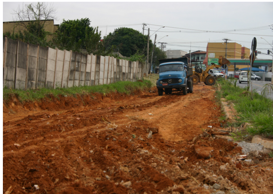
Obras de duplicação foram iniciadas em meta entregar no mês de julho
