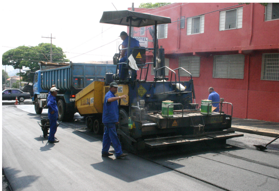
Após etapa já concluída na Região Central, Prefeitura inicia novas obras de recape
