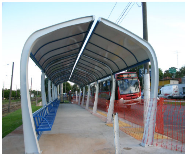
Ponto de ônibus da Estação está praticamente pronto e outros quatro serão reformados
