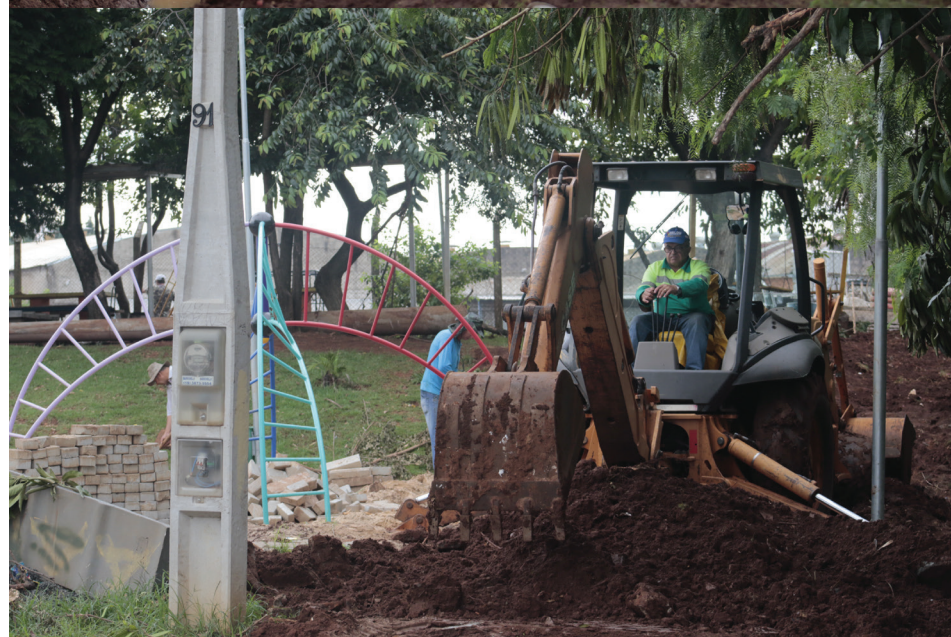
Para evitar alagamentos na Escola Alfredo de Castro Donaire foram implantados 54 metros de tubulação da nova galeria de águas pluviais; trabalho deve ser finalizado nos próximos dias
