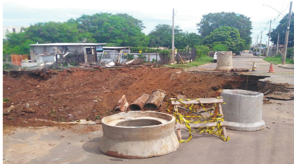
Rua Joaquim Pereira dos Santos, antiga 8 Jd. Bandeirantes - Em fase de recuperação
