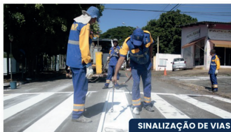
SINALIZAÇÃO DE VIAS
